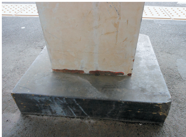
写真1 鋼柱基部の塗膜の剥離と腐食状況
