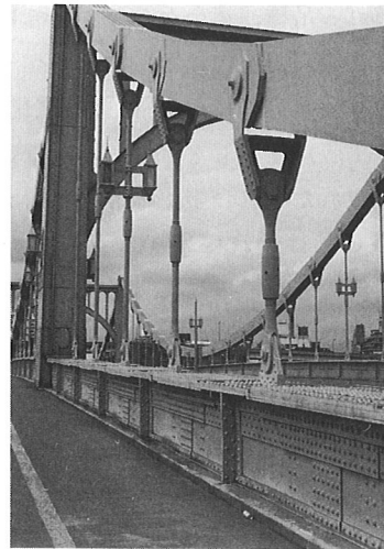
写真-5 隅田川の清洲橋(1977年9月撮影, 田島)
