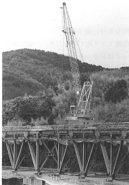
写真-9 トラベラークレーン
