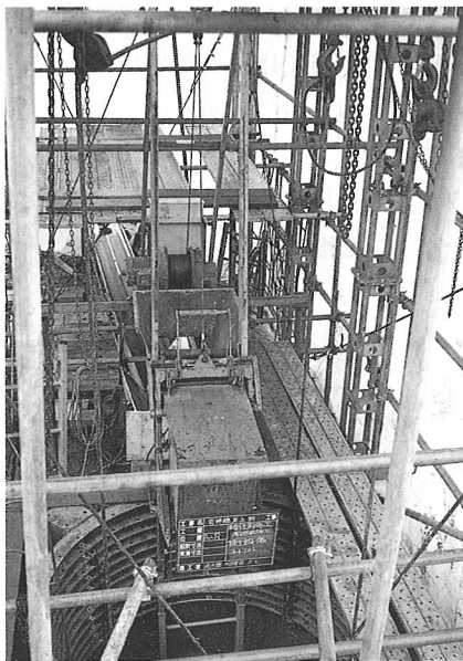
写真-4 排土設備
