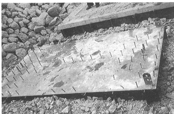
写真-2 スタッドの破壊状況
