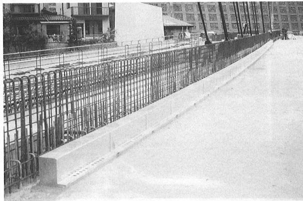
写真-6 鋼製排水溝
