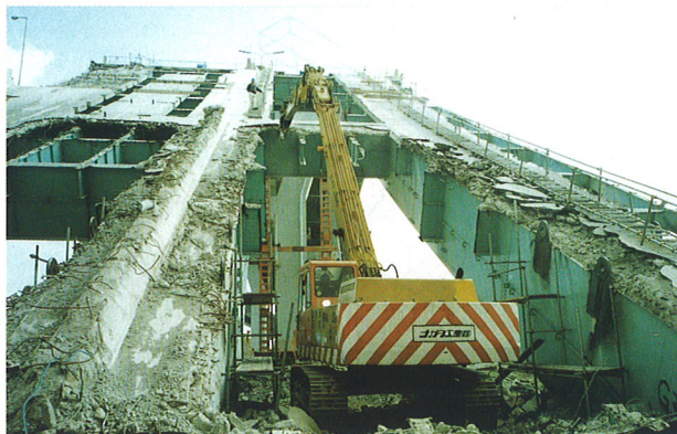
写真4 床版破碎状況
