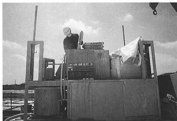
写真6 モルタルプラント
