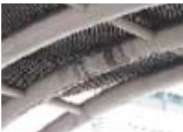
写真1 アーチリブへの漏水状況
