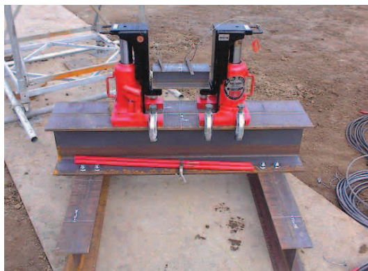
仮設柱上部構造体
