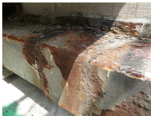
写真2 鋼製カバーの腐食
