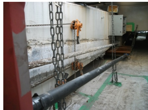
写真 5 既設ケーブルと仮設ケーブル
