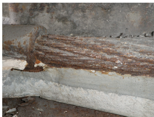
写真3 PCケーブルの腐食
