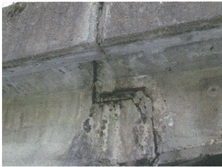
写真1 旧八田橋の損傷箇所（ゲルバー構造部）
