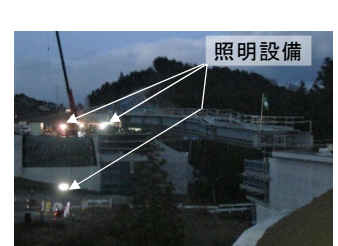
③ 照明設備
