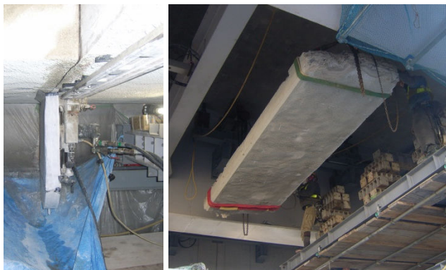
写真 2.3 カッター切断、吊下げ撤去状況 一部の吹付コンクリートは、落下防止対策で施工され
