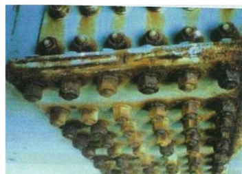
写真 1 塗装橋梁の高力ボルト継手部の腐食
