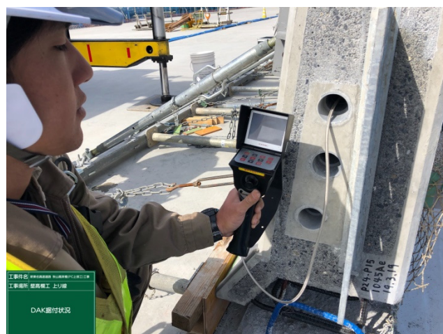
写真12 ファイバースコープ漏出確認
