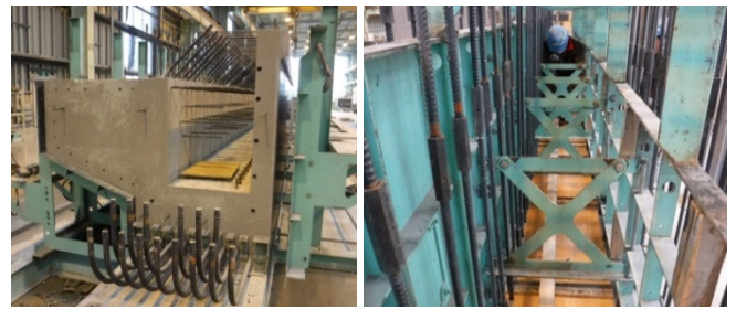
写真 3 内側露出鉄筋の状況 写真 4 内側型枠配置状況
