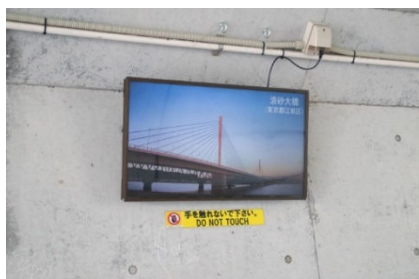
写真 6 地下通路に設置した液晶モニタ
