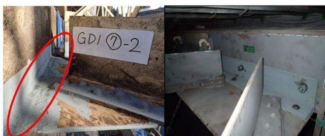
写真 5 下横構ガセットの腐食部と当て板補強設置状況
