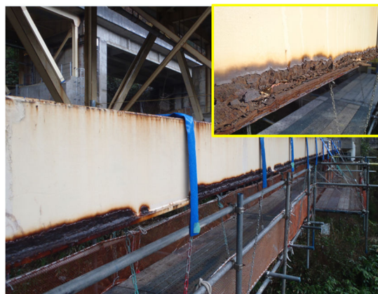
写真1 下弦材の腐食状況
