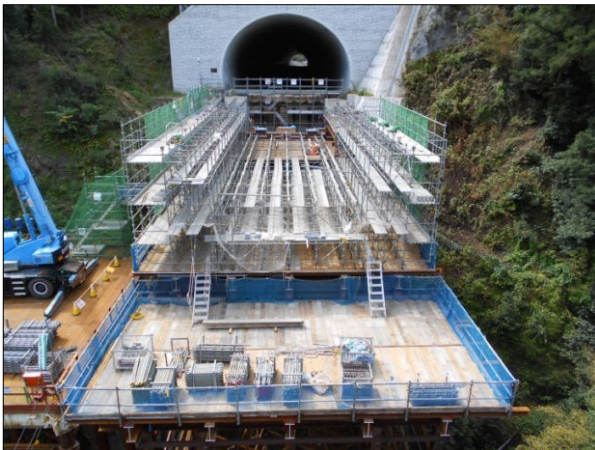
写真4 A1 くさび緊結式支保工
