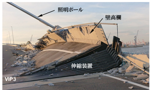
写真2 VIP3上鋼床版張出部の変形(被災直後)
