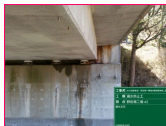
写真19 着手前の漏水状況
