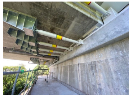
写真18 ダンパー視認状況
