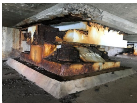
写真2 A2橋台BP-A支承腐食状況
