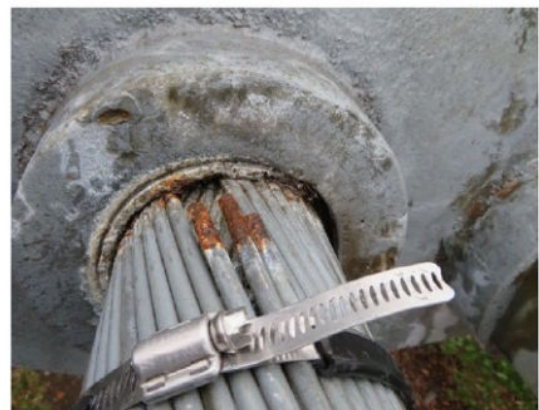
写真1 主ケーブル素線破断状況
