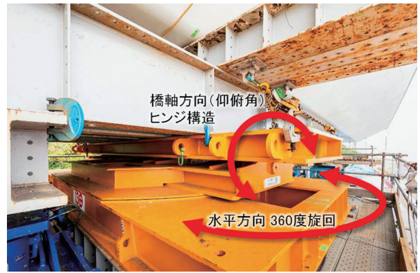
写真3 ターンテーブル
