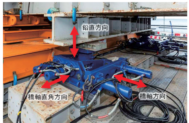
写真2 3次元ジャッキ(台車上)
