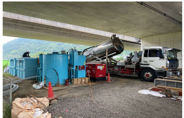
写真 12 汚濁水処理設備
