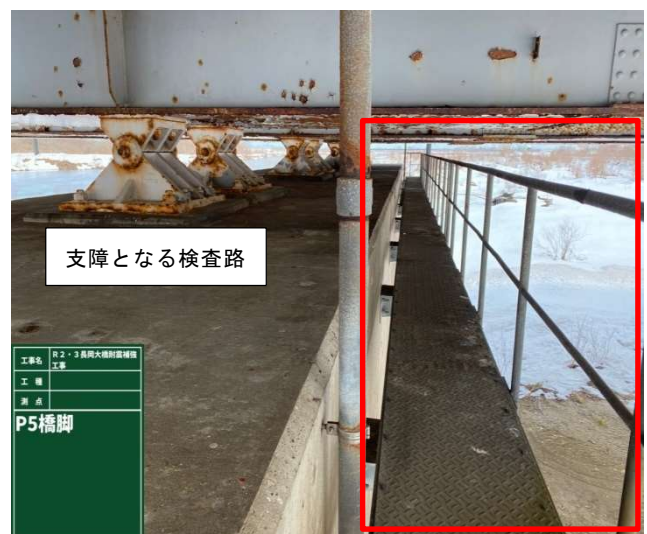
写真 13 検査路との干渉
