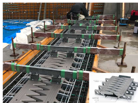
写真4 KMA ジョイント（橋梁メンテナンス）
