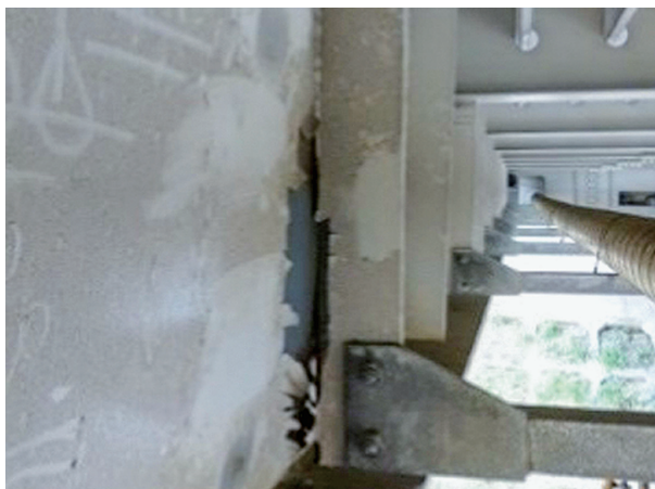
(b) 垂直補剛材溶接部の破断
