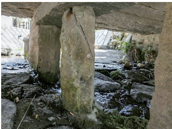
(b) 亀裂を有した石の橋脚
