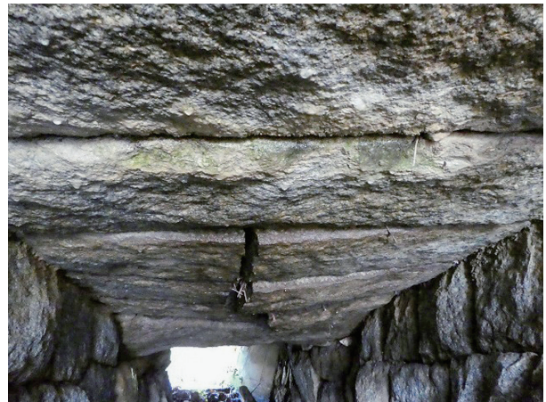
(a) 亀裂の生じた桁
