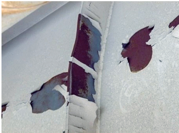
(a) 垂直補剛材の座屈
