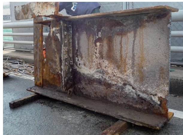
(c) バラベット側の腐食状況 (撤去時)
