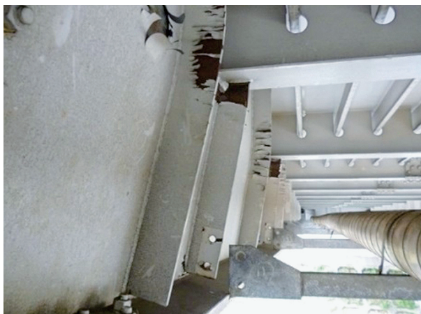
(c) 横支材と垂直補剛材ボルト接合部破断
