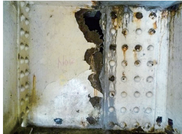
(a) 損傷状況
