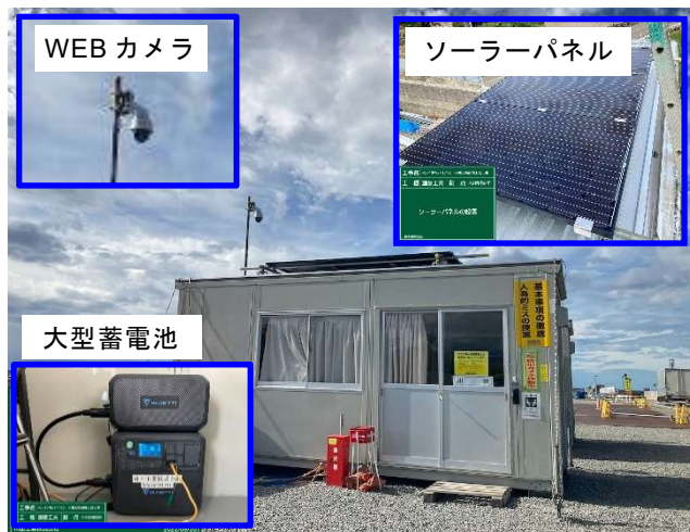
写真 5 WEB カメラ設置状況
