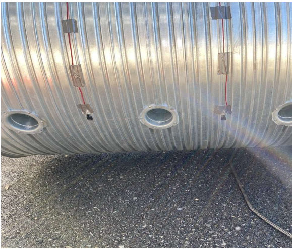
写真7 コンクリート充填管理システム 「ジュテンダ」センサー設置状況
