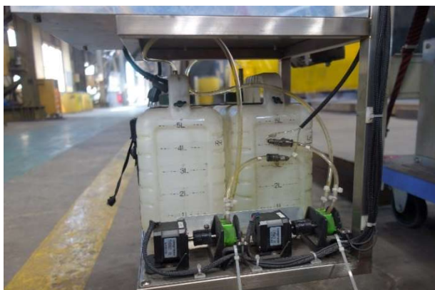
写真5 水タンクとポンプ
