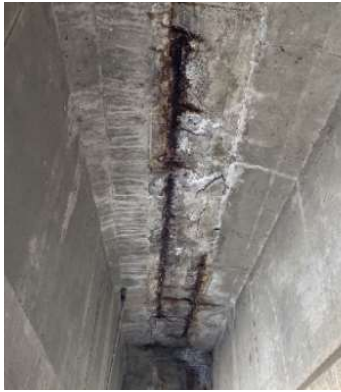
写真2 A橋間詰床版の損傷状況
